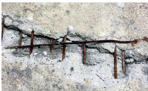
Sprickbildning och avflagnig av betong på grund av korrosion hos armeringen
