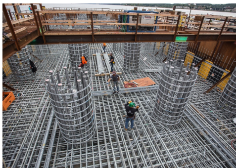
Innan man valde varmförzinkad armering för Mario M. Cuomo-bron, utvecklade New Yorks Genomfartsmyndighet en korrosionsskyddsplan för att identifiera exponering, nedbrytningsmekanismer, design- och konstruktionsstrategier samt livscykelkostnader.
