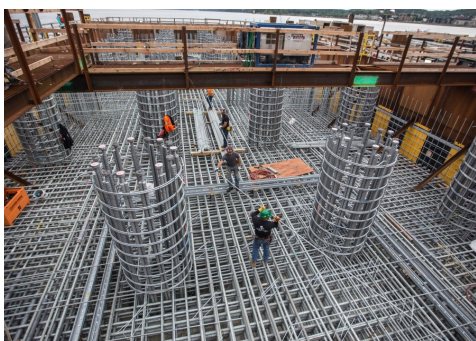
Antes de elegir armaduras galvanizadas para el Puente Mario M. Cuomo, la Autoridad de Autopistas de Nueva York desarrolló un Plan de Protección contra la Corrosión para identificar la exposición, los mecanismos de degradación, las estrategias de diseño y construcción y los costes del ciclo de vida.
